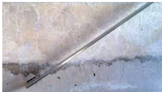
Нов бетон с дефекти, които трябва да бъдат запълнени
